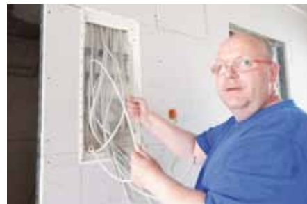
Elektromeister Andreas Baumbach an einer Unterverteilung
